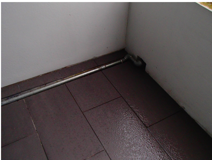
Afløbsrør tilsluttet plantekumme
